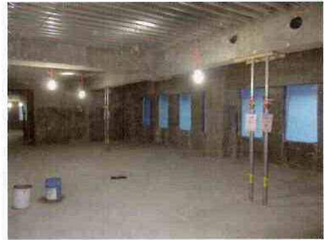
写真 8.1-12 設計基準強度発現前のスラブ下状況
